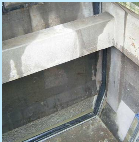
新潟県中越地震による下水処理場のエアレーションの伸縮目地の目開きをRE150E型で復旧
