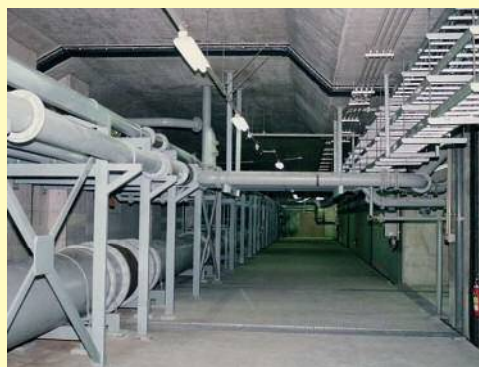
東海地震に備えて神奈川県内の下水道施設・地下管廊部の伸縮目地に設置されたRE150E型
