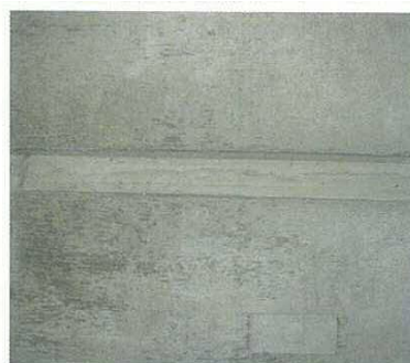
(クラックが化粧目地部に発生したことを確認)
