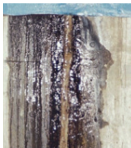
漏水状況確認
