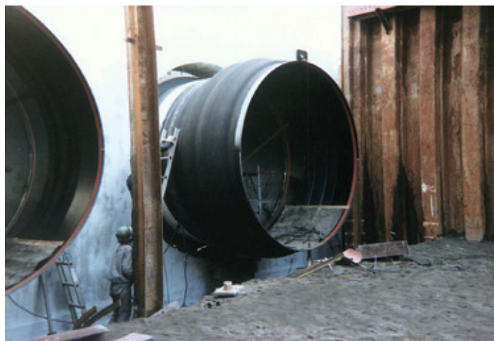
【導水路に設置されたスーパージョイント口径3200mm】
