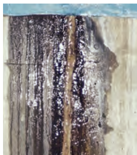
漏水状況確認
