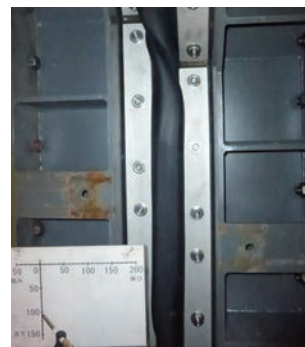
沈下量 100mm確認
